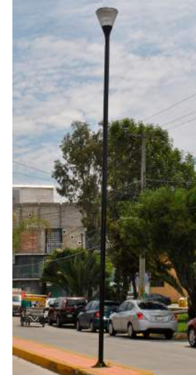
POSTE CON PUNTA DE POSTE FUTURA NACIONAL
