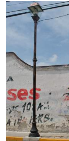
POSTE RECTO CON BASE CHILPANCINGO Y LUMINARIO HACIENDA
